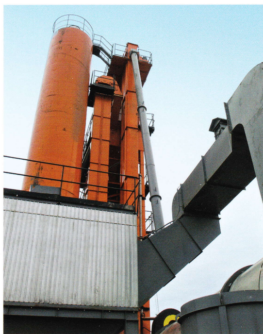
Filtro impianto asfalti
